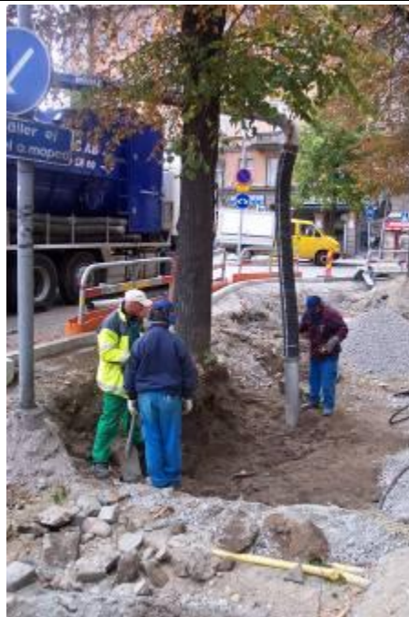
Abb. 2: Wurzelraum während der Freilegung unter Einsatz eines Saugbaggers (vgl. [xi]). Die Wurzeln haben die zu klein bemessene Pflanzgrube nicht verlassen.
