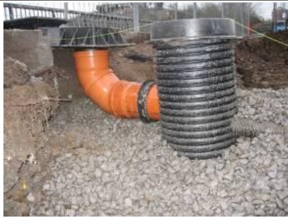
Abb. 12: Nutzung des Regenwassers von Geh- und Fahrradwegen: Straßeneinlauf und Sandfang
