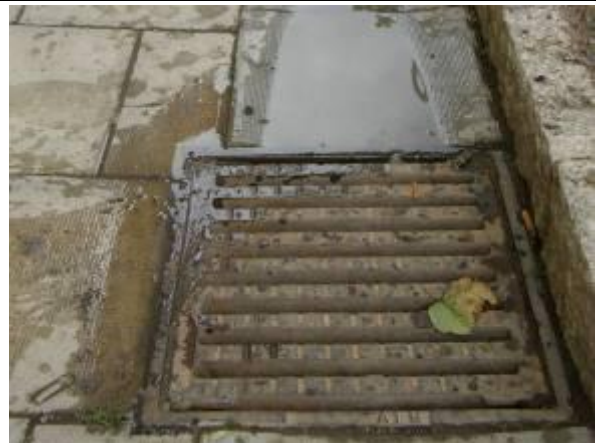
Abb. 11: Einleitung über offene Entwässerungsrinnen in den Straßeneinlauf
